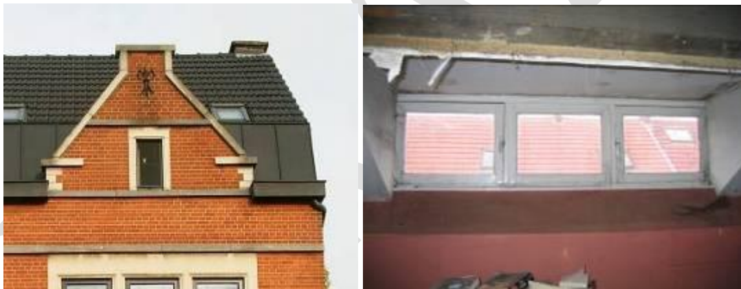
Afbeelding 6 – voorbeelden van dampdichte lagen aan de buitenzijde van de isolatielaag bij het na-isoleren van hellende daken: mansardedak met strook in zink, dakkapel met plat dak,
