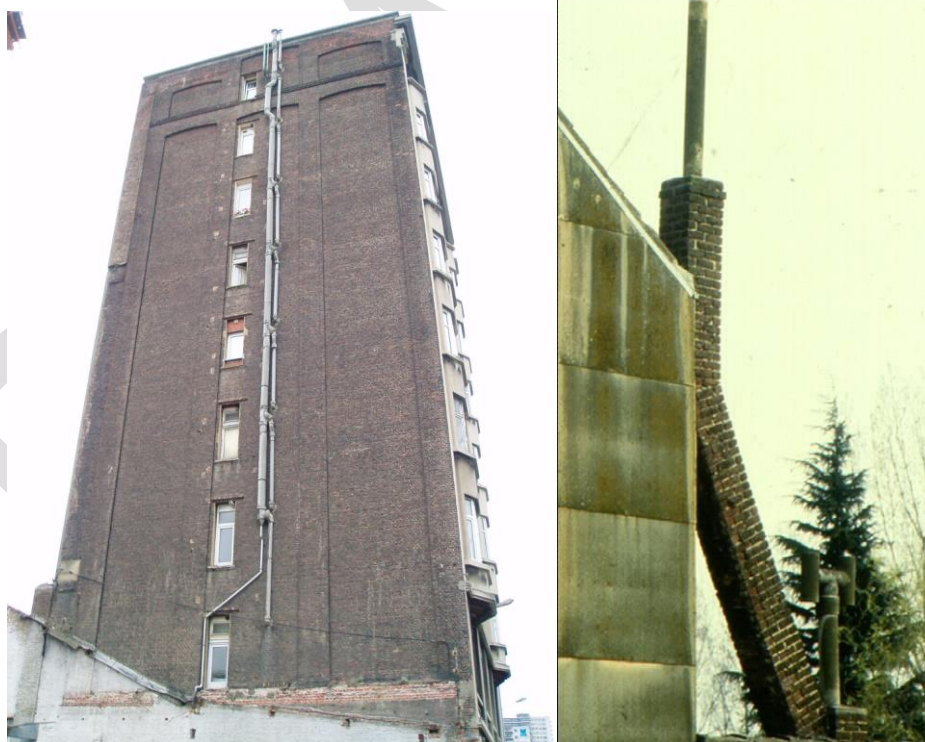
Figure 18 : des conduits d'ancienne cheminée extérieurs ou en mauvais état ne conviendront pas pour la ventilation naturelle
