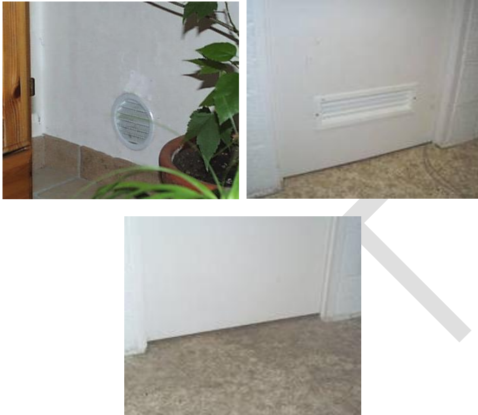
Figure 26 : trois configurations pour le transfert : par une grille murale, par une grille dans la porte et par une fente sous celle-ci
