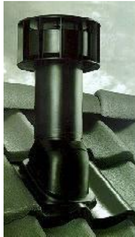
Figure 16 : sortie en toiture d'une extraction d'air naturelle (au moins 50 cm de la toiture)
