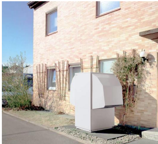
Figure 40 : PAC sur l'air placée en extérieur
