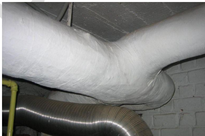
Figure 60 : isolation de tuyauteries pouvant contenir de l'amiante
