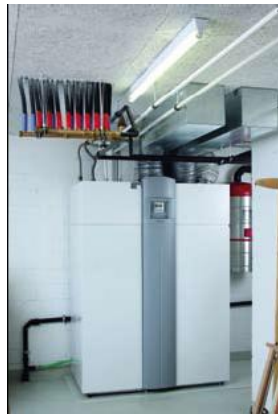
Figure 47 : PAC sur l'air : l'air extérieur est amené à l'évaporateur via des canalisations
