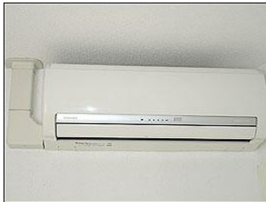
Figure 44 : unité intérieure de système de climatisation
