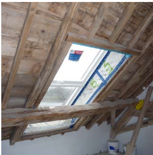
Freine-vapeur et raccords étanches au niveau des encadrements des fenêtres de toit.
