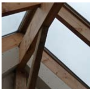
Serre en toiture pour capter la chaleur en hiver et rafraîchir la maison en été par tirage thermique. La serre est séparée de l'ambiance intérieure par du double vitrage.
