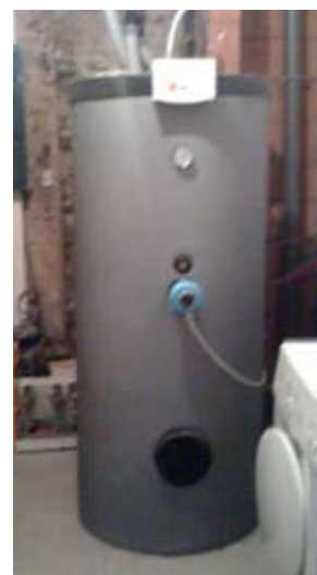
Chauffe-eau solaire - 500 l.
