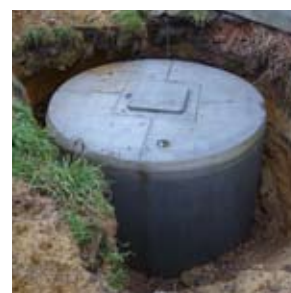
Citerne d'eau de pluie.
