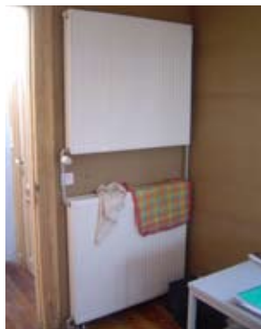
Radiateurs surdimensionnés, à basse température.
