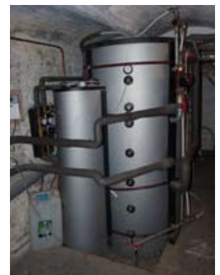
Ballons de préparation de l'eau chaude sanitaire.
