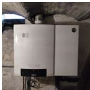
Chaudière gaz à condensation.
