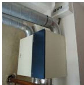
Ventilation double flux avec échangeur de chaleur.
