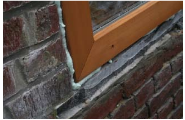
Seuil en pierre coupé pour éviter tout pont thermique. Injection de mousse isolante pour étanchéiser les joints entre les châssis et le mur.
