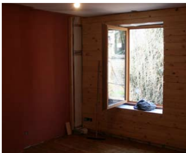
Freine-vapeur et bardage en bois du côté intérieur des façades.
