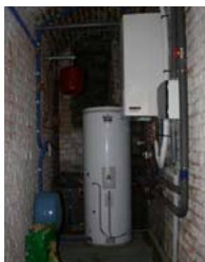
Unité intérieure de la PAC (à droite) et ballon solaire.
