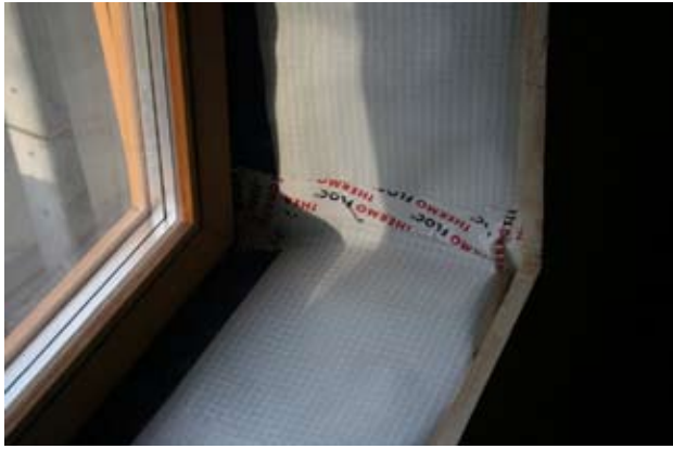
Châssis en mélèze avec triple vitrage. Étanchéité à l'air assurée au niveau des fenêtres via freine vapeur et bandes de raccords entre les lés.
