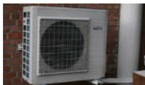
Unité extérieure de la PAC.
