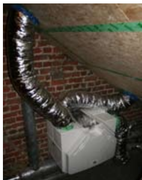
Echangeur de chaleur (VMC).
