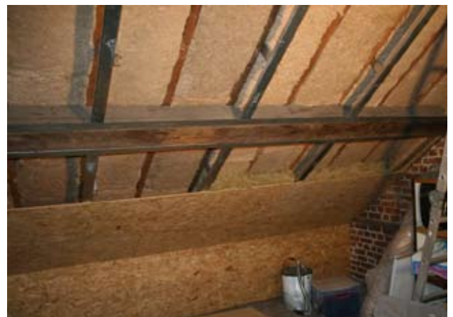
Toiture à versants : isolation en laine de chanvre (récupérée sur un autre chantier) et en laine minérale (choisie en complément car moins chère) dans toiture existante.
